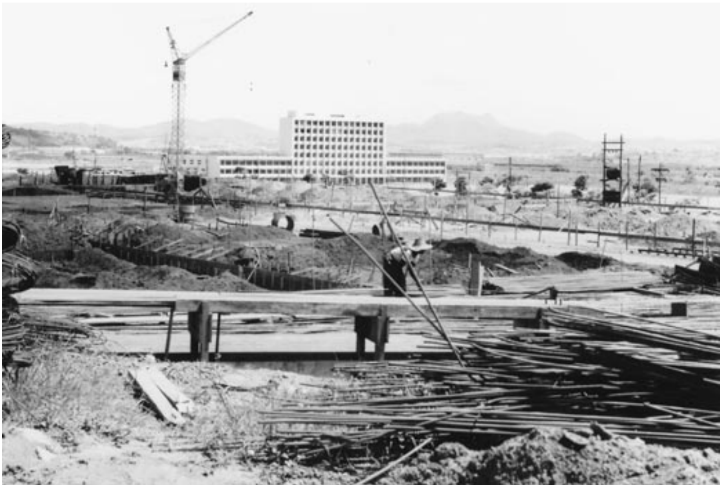
Construção do edifício dos departamentos de história e Geografia da FFCL, 1964. Fotógrafo desconhecido. Fonte: CCS Jornal da USP.
