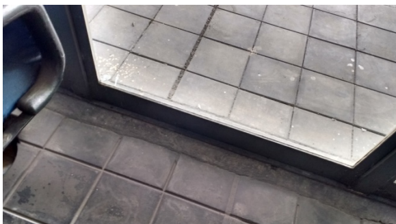
Diferença de nível entre áreas da varanda da fachada nordeste.
