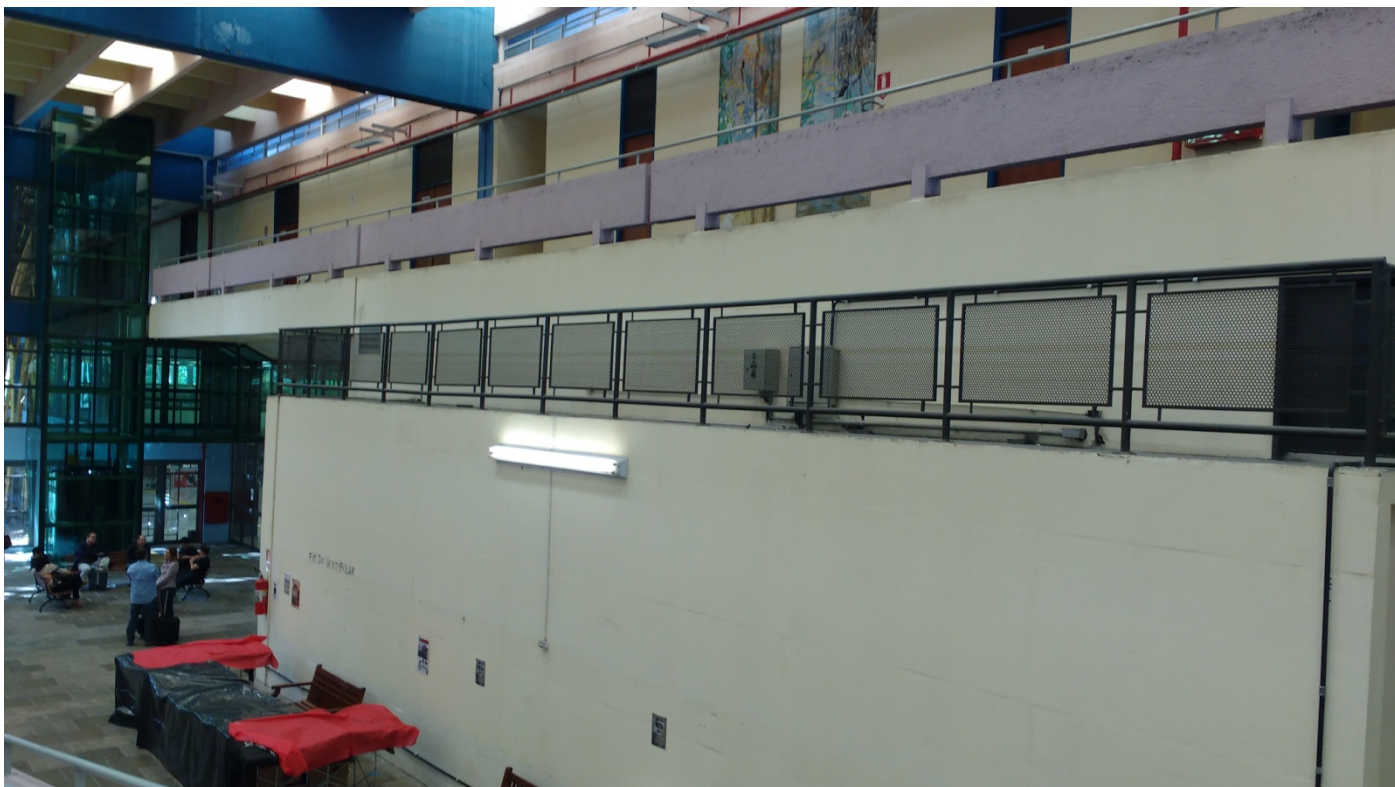
Volume de entrada do auditório, pintado em branco e com várias interferências visuais acrescentadas ao edifício (guarda-corpo, iluminação, extintor, tubulação etc).
