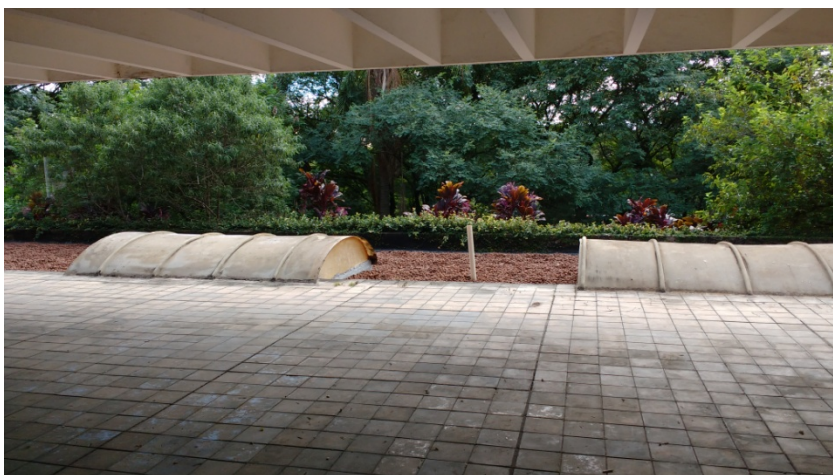
Ao lado: abrigos para iluminação e ventilação não originais na fachada nordeste.
