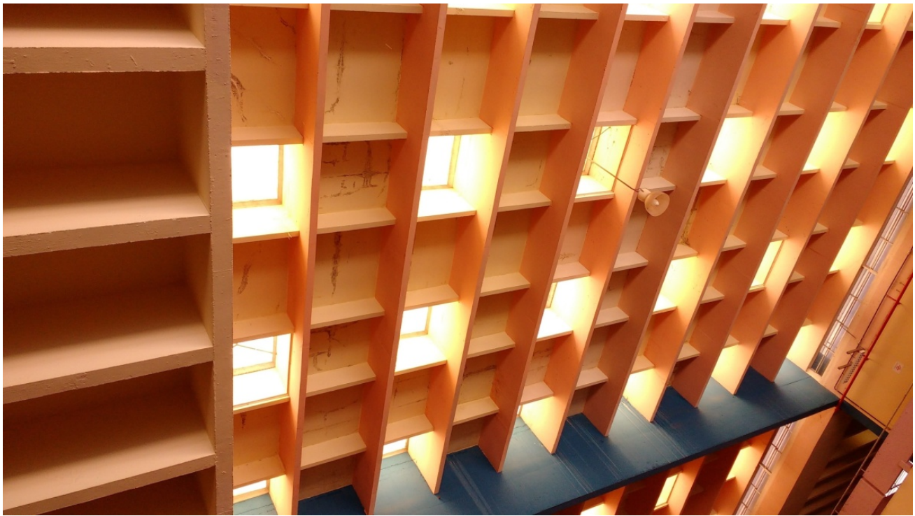
Foto da grelha de cobertura do vão central em tom magenta claro e uma das vigas principais, em azul. Notar trechos da laje com ferragens em processo de oxidação.
