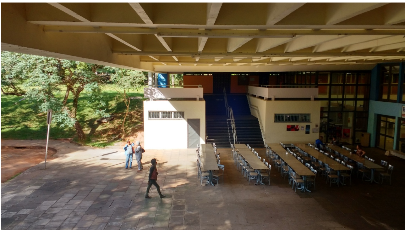
Entrada principal do edifício, com estrutura principal em azul (embora com trecho em dois tons), volumes junto à escada e grelha estrutural na cor branco e alvenarias em laranja. Os corrimãos metálicos que inexistiam originalmente estão pintados em cinza claro e as esquadrias metálicas em cinza escuro. Nos volumes que ladeiam as escadas foram abertas porta e janela inexistentes no edifício original.
